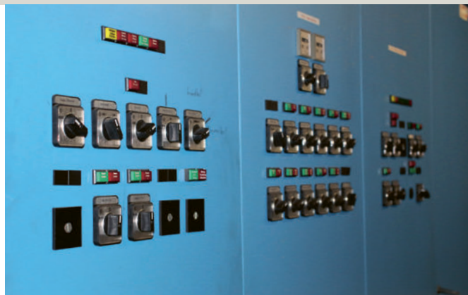
Heizung, Schulhaus Risi
