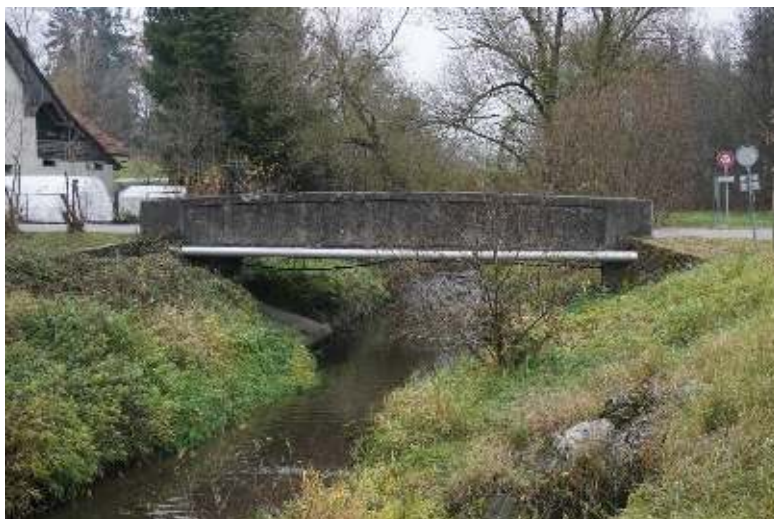
Wasserleitung isoliert unterwasserseitig
