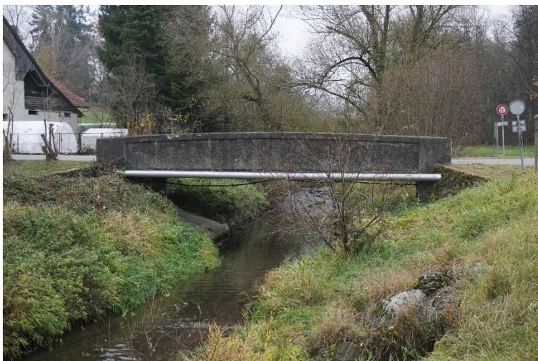
Wasserleitung isoliert unterwasserseitig
